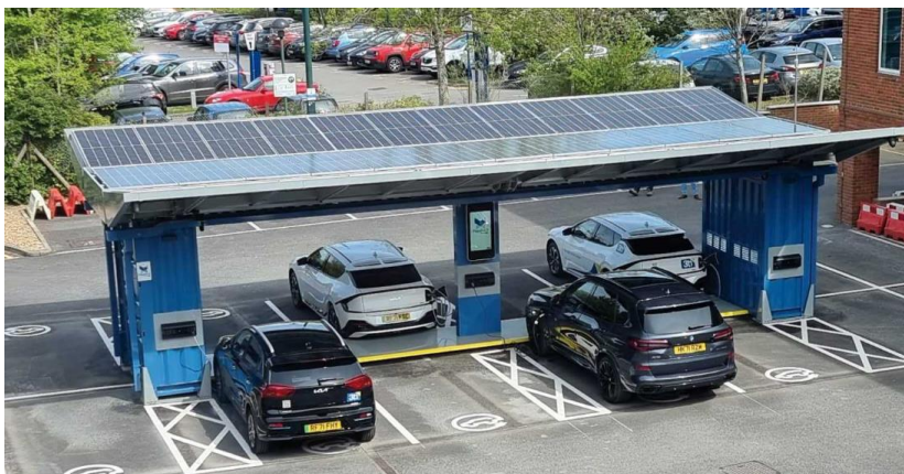
Figure 1: Papilio3 Mini Solar Carpark & EV Charging Unit
